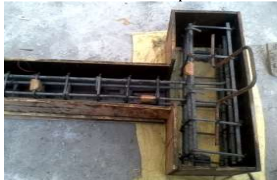
Fig:5 Column Setup Embedded With SA
